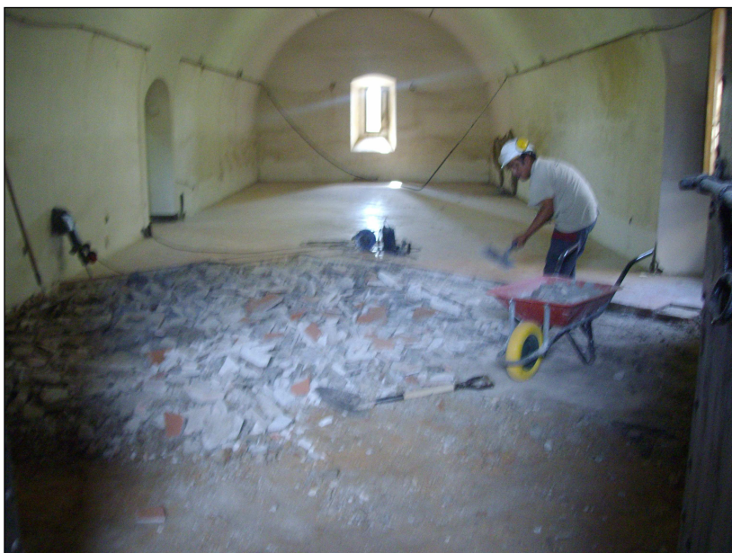
Procés d'afectació del paviment u.e. 101.
