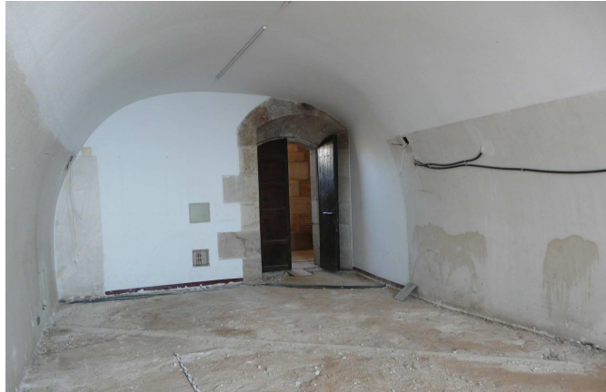
Vista de la porta de la Sala 11. S'observa que està completament descentrada respecte de la volta que s'ha hagut de modificar per col·locar-hi la porta
