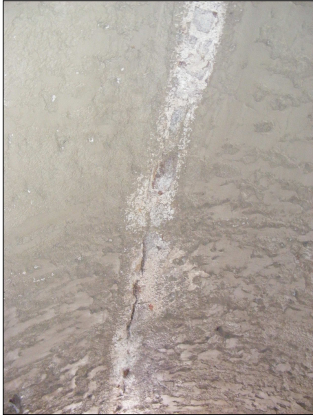
Detall d'una de les patologies que presentava la volta u.e. 14.
